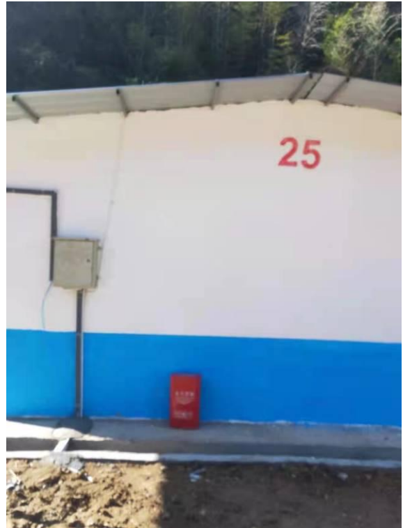
工库房已设灭火器
