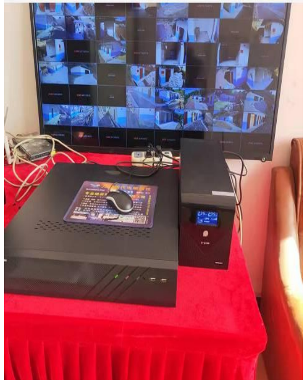
视频监控系统已设 UPS 电影
