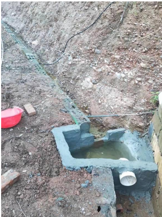
混药工房已增加一级沉淀池
