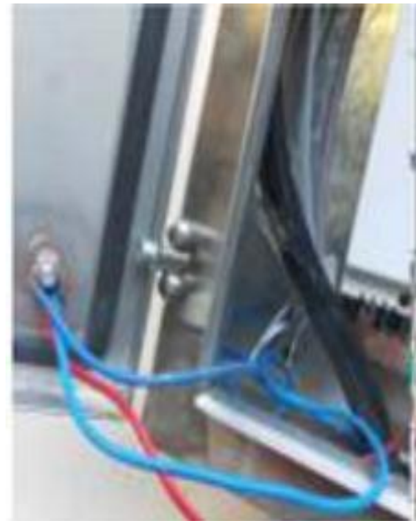
配电箱体已接地，箱门已跨接
