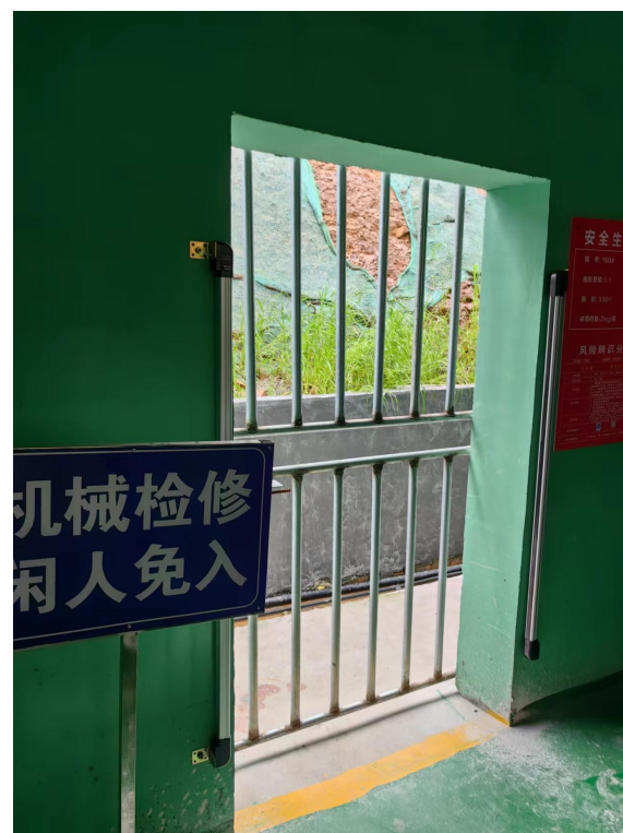
已安装防入侵停机装置
