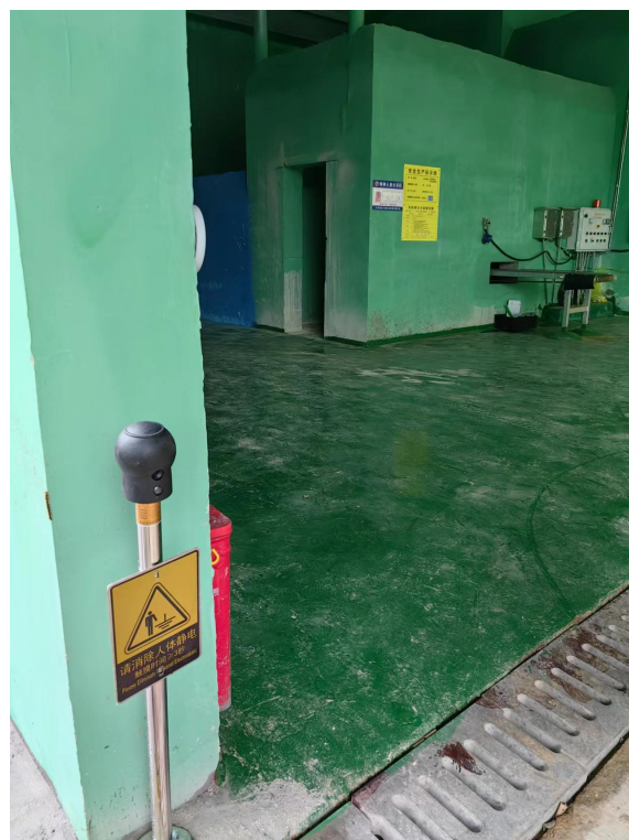
已安装静电释放仪
