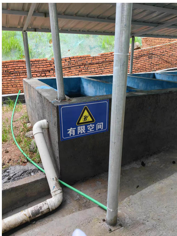
沉淀池已悬挂“有限空间”警示牌
