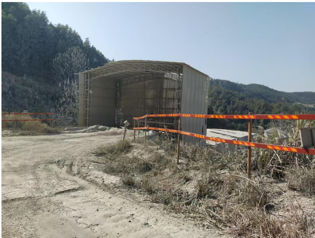
卸矿口安全护栏及车挡设施
